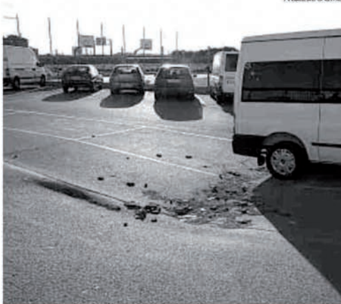
►► La zona hundida se encuentra en un aparcamiento cercano al colegio.
